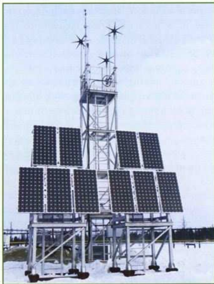
Контрольный пункт системы линейной телемеханики на базе ветрогенераторов и солнечных батарей
